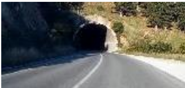
Відсутнє освітлення в тунелі
