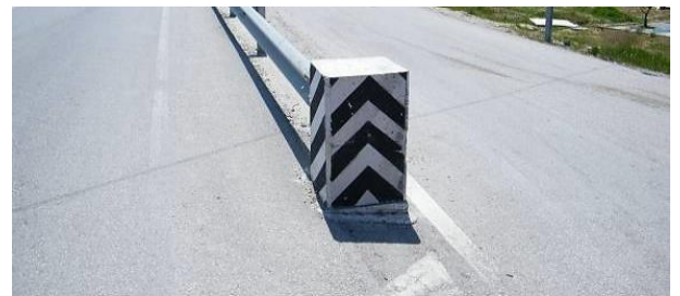
Небезпечний «кінцевий елемент» - бетонний блок
