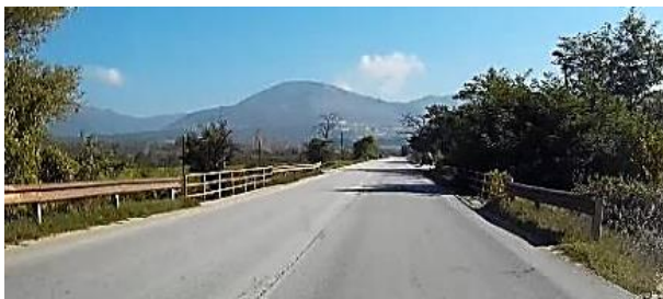
Небезпечні бар'єрні огороження (не об'єднані в систему)
