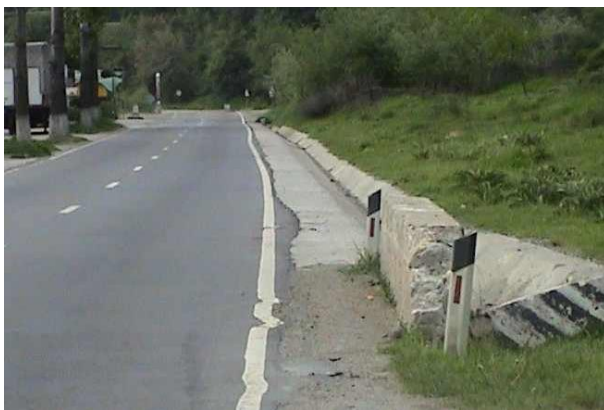
Небезпечна стінка оголовку водопропускної труби
